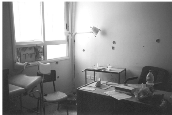
Jénine, Hopital de l'UNRWA, 19 avril 2002 Bureau mitraillé, 1 er étage
