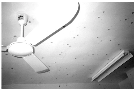
Jénine, Hopital de l'UNRWA, 19 avril 2002 Plafond du hall d'entrée criblé d'éclat d'une grenade à fragmentation
