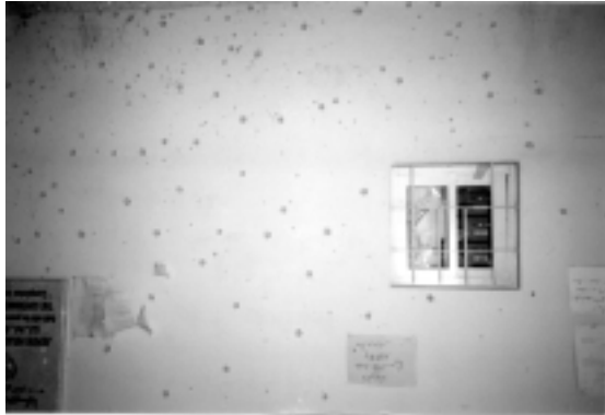
Jénine, Hopital de l'UNRWA, 19 avril 2002 Hall d'entrée criblé d'éclat d'une grenade à fragmentation
